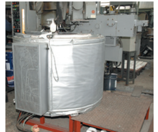
電気式溶解保持炉
